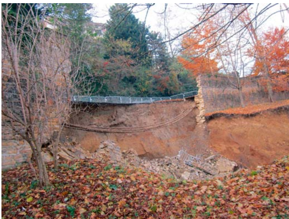
Effondrement d'une balme, hivers 2013 (9 ème arrondissement)
