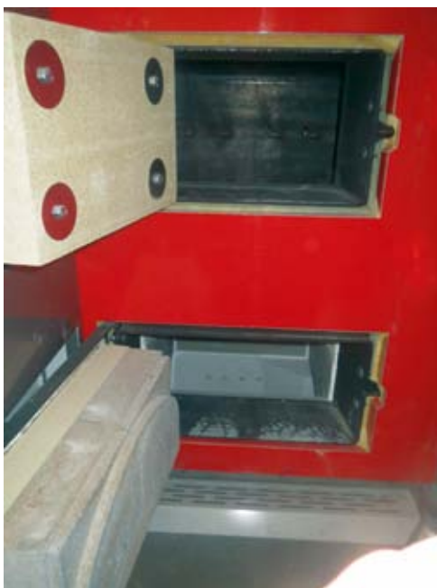
Chaufferie bois du Groupe Scolaire Laborde (9 ème arrondissement)
