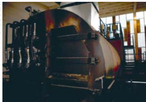
Chaufferie bois de la Duchère (9 ème arrondissement)
