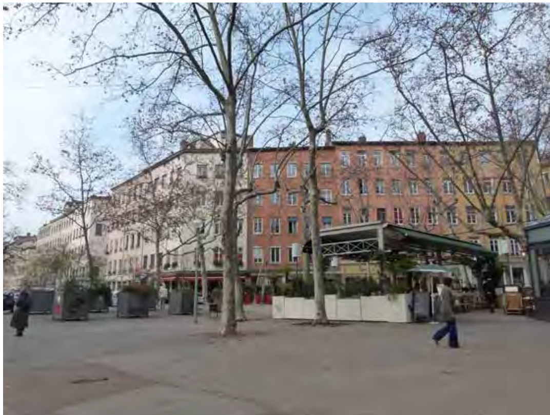
Sol faïencé en mauvais état (enrobé, enrobé rouge, asphalte, pavés autobloquants)
